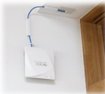
教室に設置された無線LANポート
